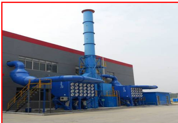
含铅废气三级高效除尘器
